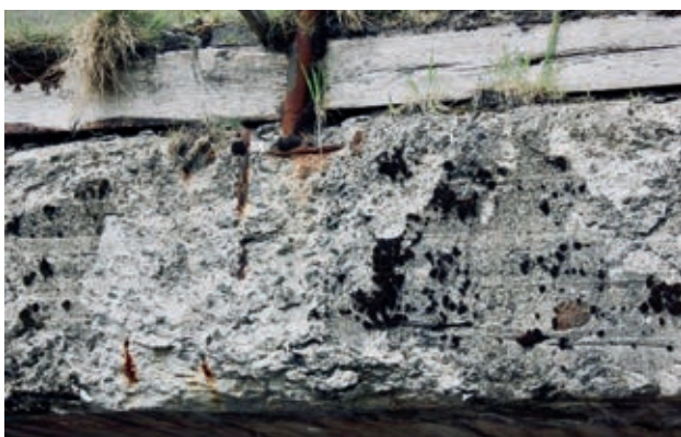
Betong flusnað av armeringini.
