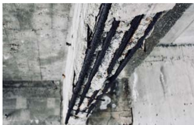
Sjónlig armering og illa farið betong
