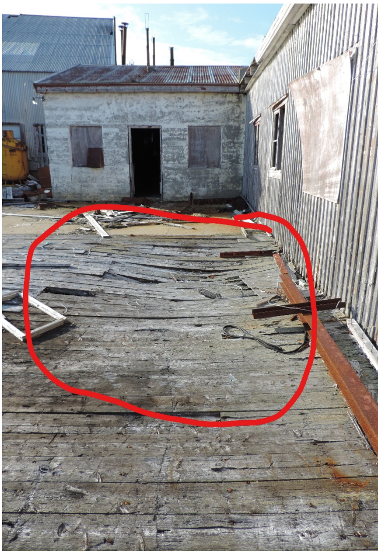
Figur 0.17 Brygge/kajanlæg B-12. Bryggens planker og understøtning rådner og kollapse.
