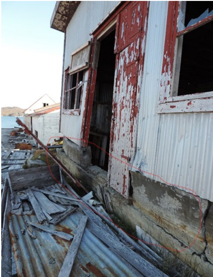
Figur 0.1 Ildsmedje B-9. Fundamentet kollapse og skubbes udad
