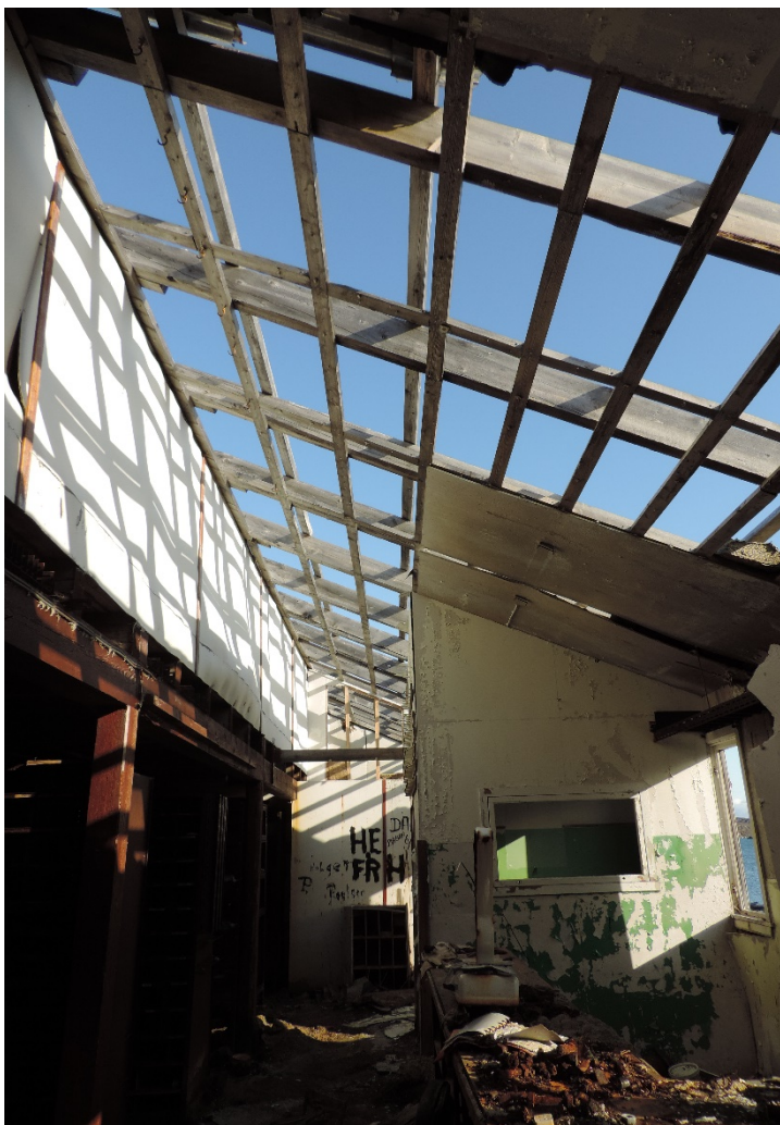
Figur 0.4 Frysehus og lager B-8. Klimaskærmen på taget er blæst væk.
