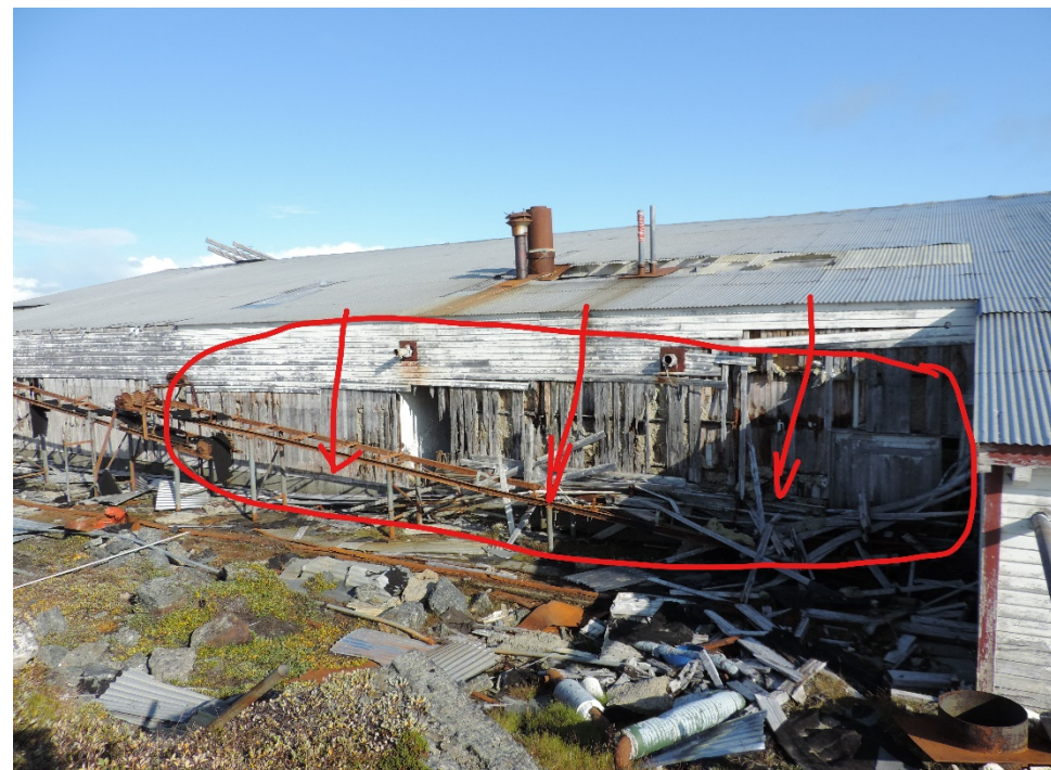
Figur 0.10 Fryseri og filétfabrik B-18 og 17. Bagside hvor beklædning mangler. Konstruktionen er blottet og ved at kollapse.
