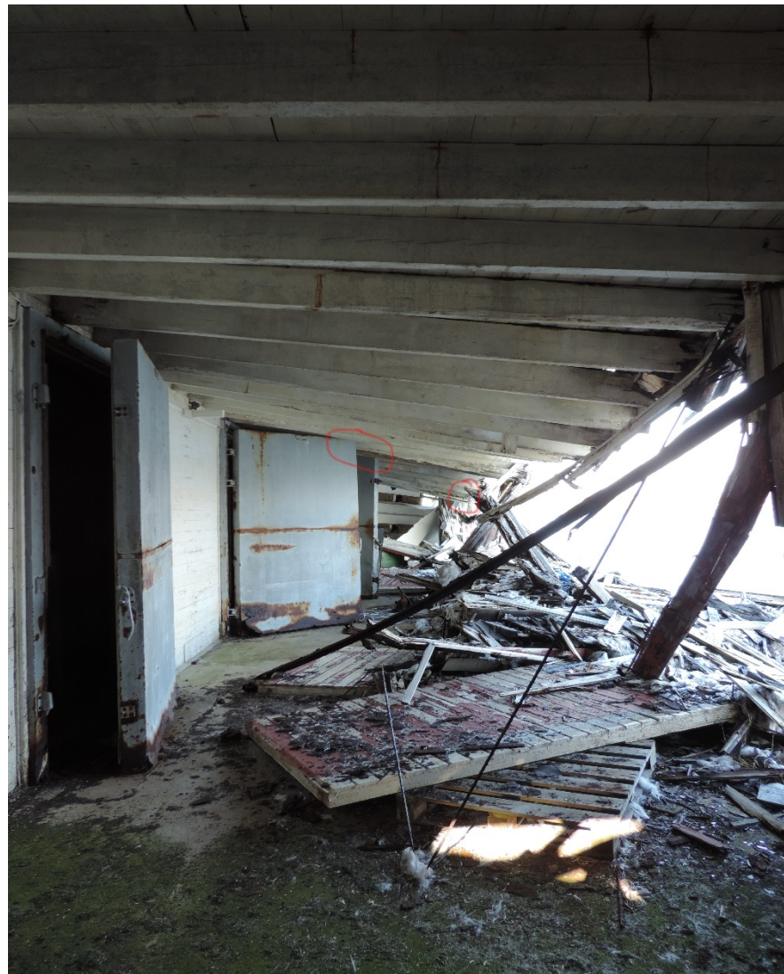
Figur 0.7 Fryseri og trawlloft B-18. Tagkonstruktion mod bryggen er sunket sammen. Hviler kun på to åbne fryserdøre og én stolpe, se markeringer.
