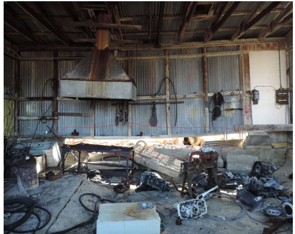
Figur 0.2 Ildsmedje B-9 interiør. Loftet synker sammen, pga. manglende fundament
