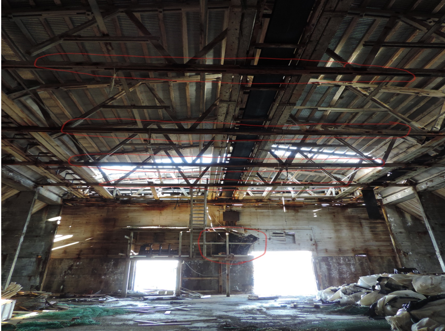
Figur 0.12 Saltsilo B-20. Porte mangler. Tagkonstruktionen bærer tre store transportbånd. Teknikgang over porte falder sammen.
