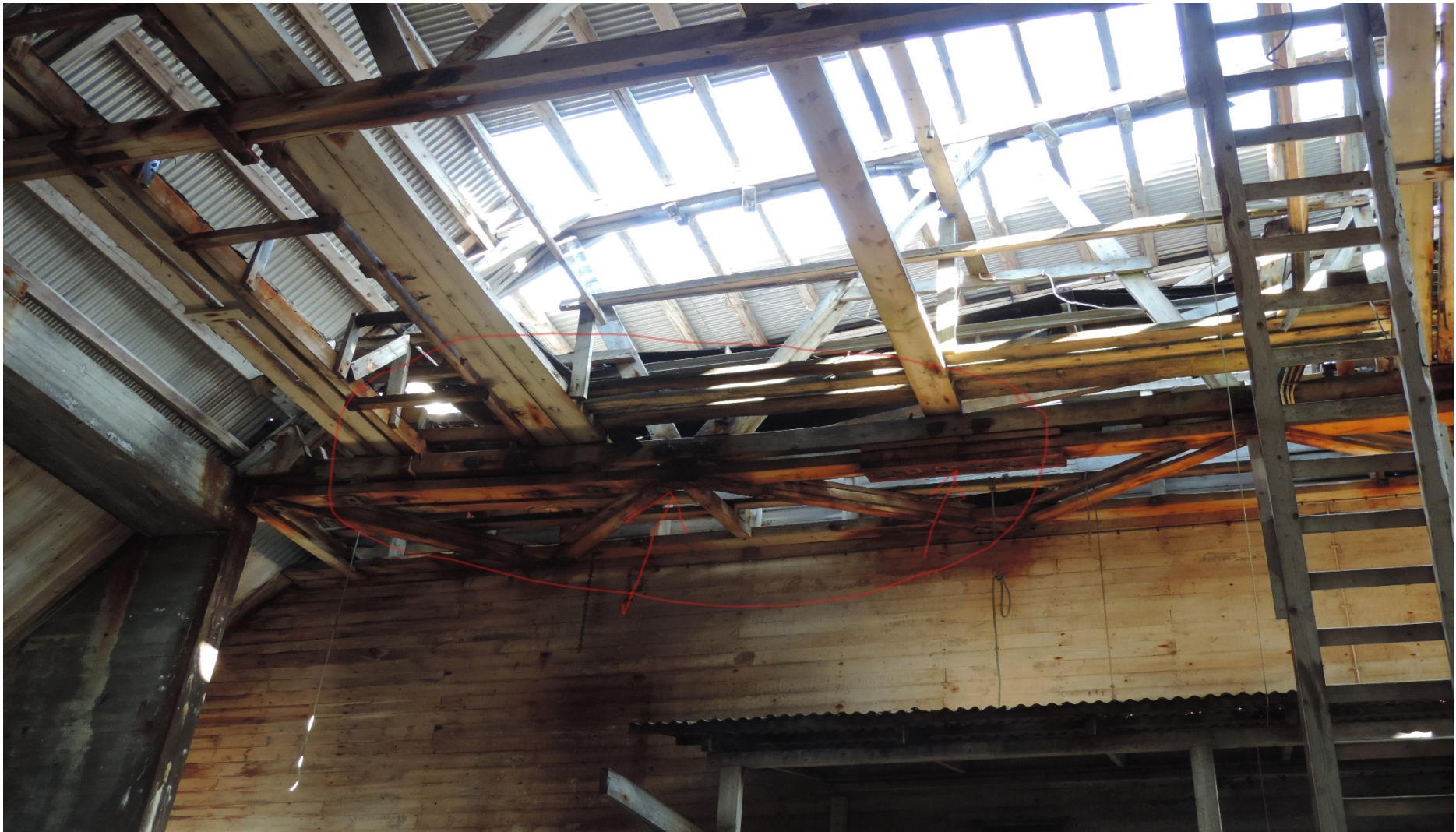
Figur 0.13 Saltsilo B-20. Bærenden konstruktion under transportbånd er boltet sammen. Bolte og beslag tæres af saltholdig fugtig luft i siloen. Pilene indikerer hvor konstruktionen er begyndt at hænge i samlingerne.
