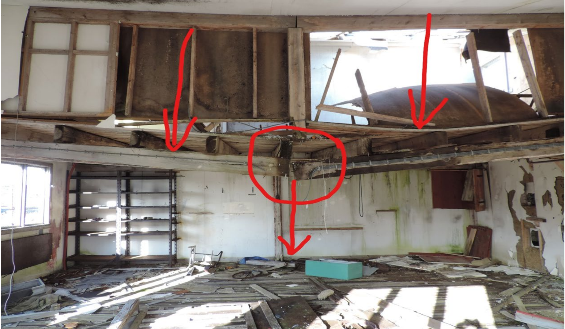
Figur 0.3 Frysehus og lager B-8. Bjælkelag uden støtte synker sammen, og 1. sal kollapser
