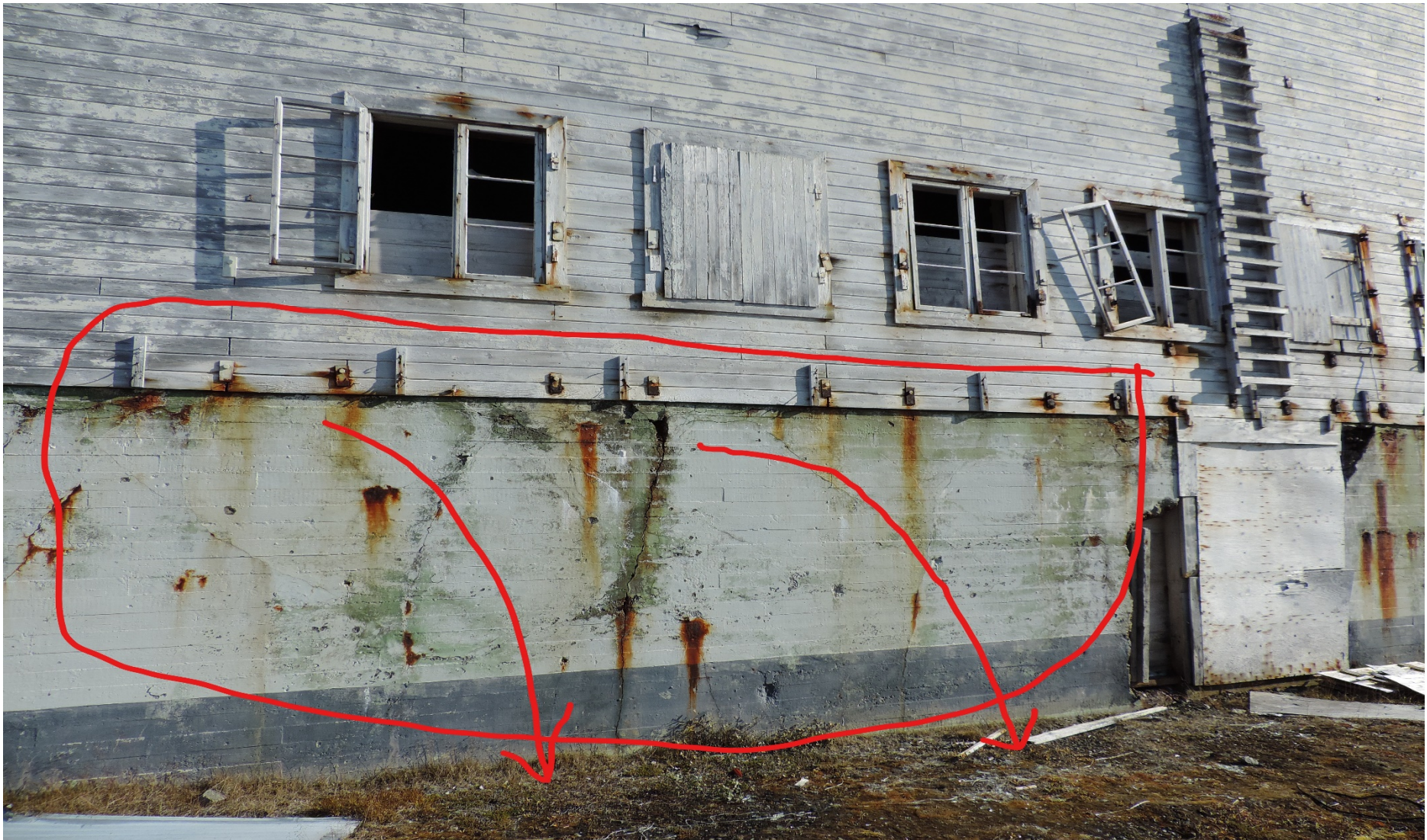
Figur 0.15 Saltsilo B-20. Armeringen i betonmuren er tæret og den svækkede mur revner og buler udad. Fare for sammenstyrtning.
