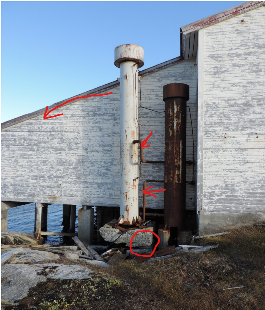
Figur 0.19 Frysehus og lager B-8. Stålskorsten ved bådrampen. Havet har gennemtæret beton og armering i soklen. Der står kun ca. 15 cm beton tilbage (se cirkel) og skorstenen hænger i to metalrør. Akut sammenstyrtningsfare.
