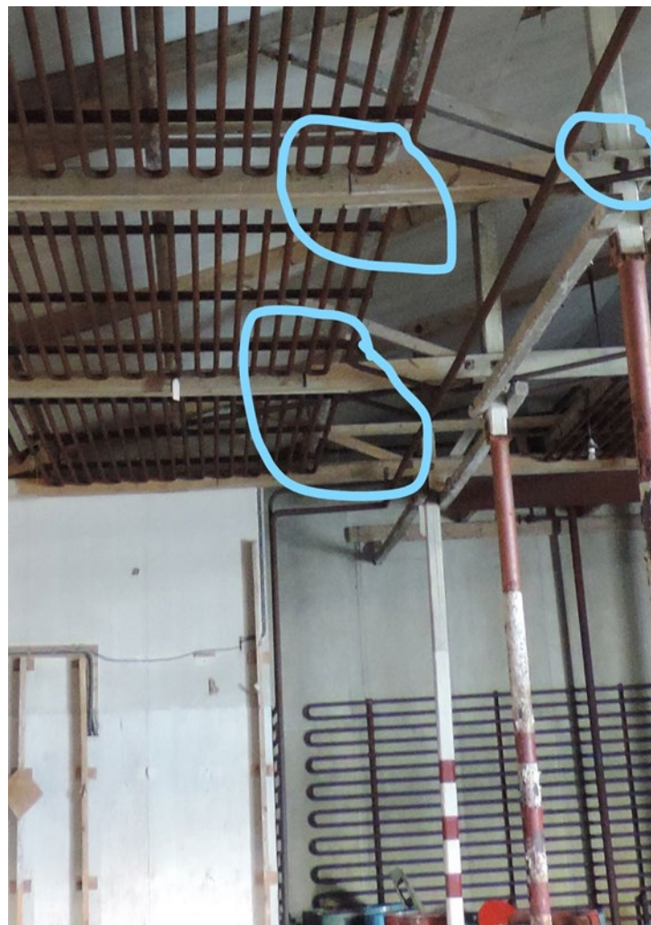
Figur 0.5 Modtagehal B-16. Markeringer viser svage samlinger i konstruktionen der bærer køleanlægget.
