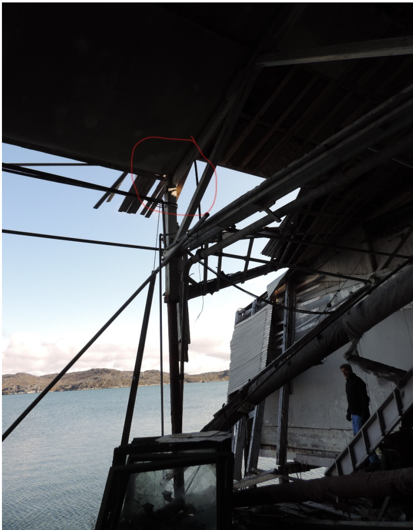
Figur 0.6 Modtagehal og filetfabrik B-16 & 17. Facade mod fjord stærk forfalden. Taget bæres her af én stolpe, der er blottet mod elementerne.
