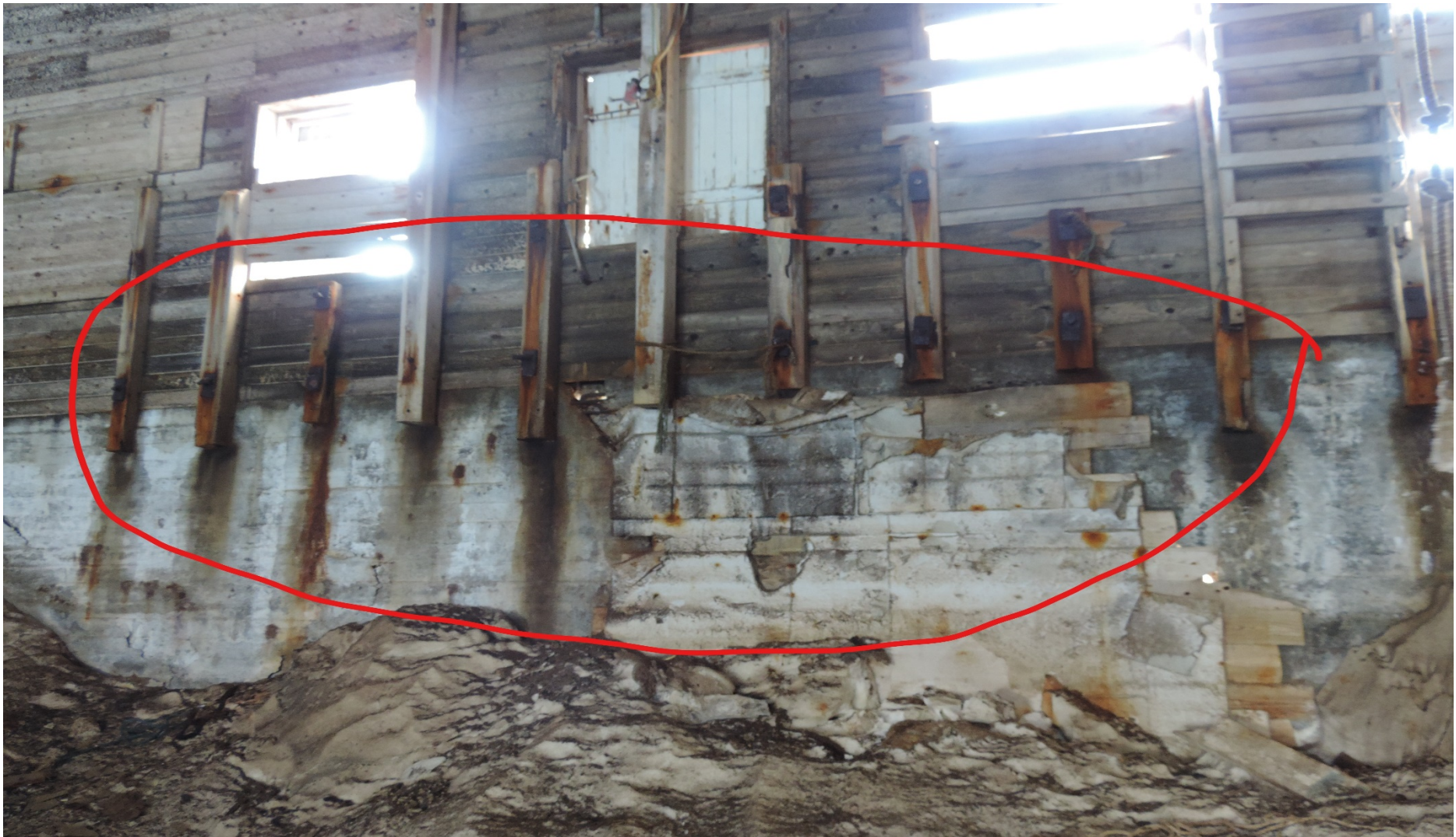
Figur 0.14 Saltsilo B-20. Endegavl indefra. Saltet tærer boltene i gavlens mangelfulde befæstning på den høje betonmur.
