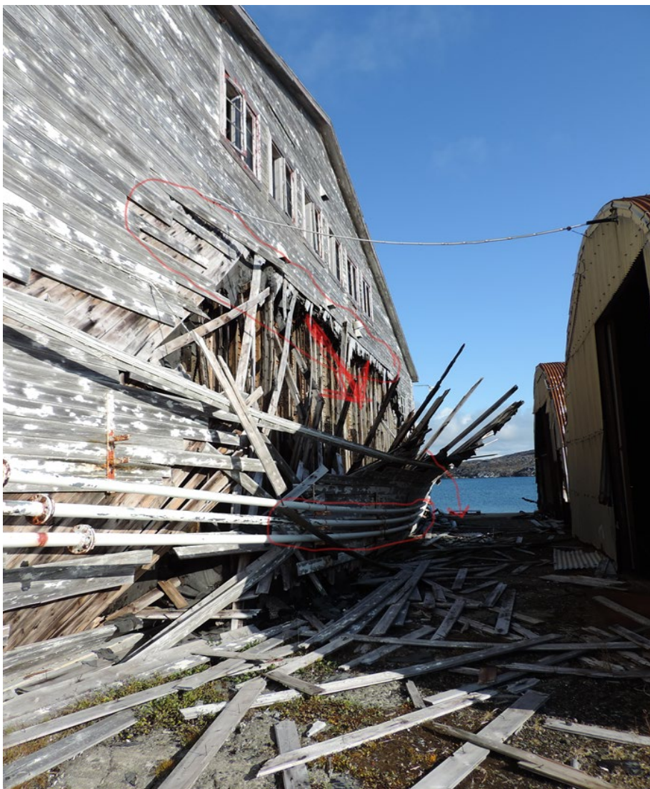
Figur 0.9 Fryseri B-18. Gavlvæg presset ud og faldet sammen. Bemærk rørføring, der holder resterne sammen. Konstruktion blottet til elementerne.
