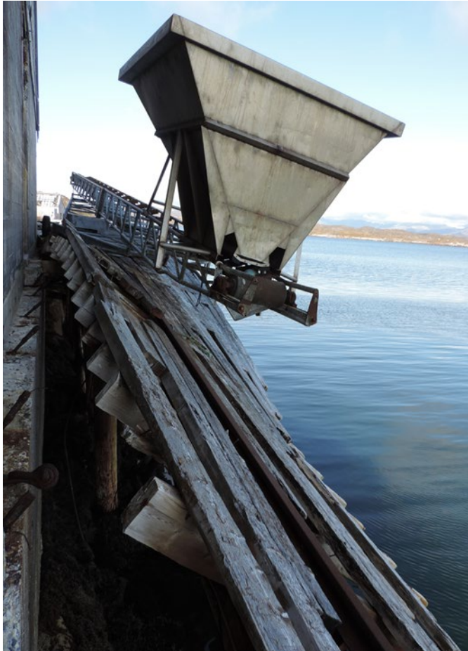
Figur 0.11 Saltsilo B-20, brygge. Eneste adgangsvej til saltsiloen er brudt sammen og falder i fjorden.
