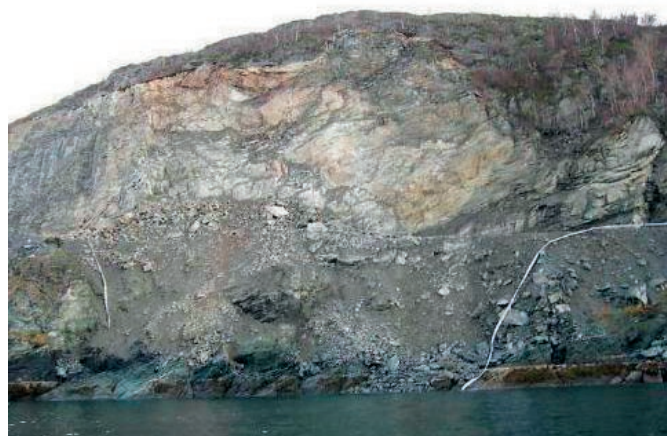
Ras ved fylkesveg 19 – Lille Lerresfjord. (Foto: Statens vegvesen)
